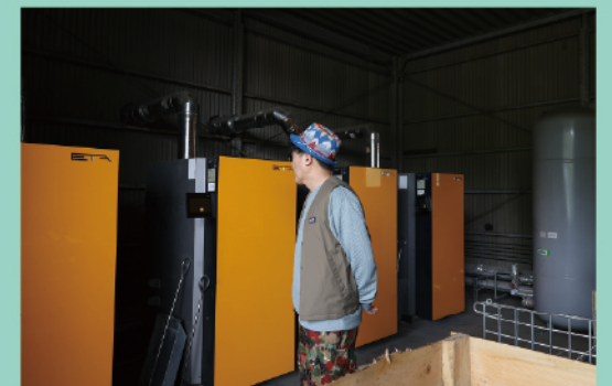
薪を利用したボイラーでエネルギーを循環している システムは他のキャンプ場にはない特徴だよ
